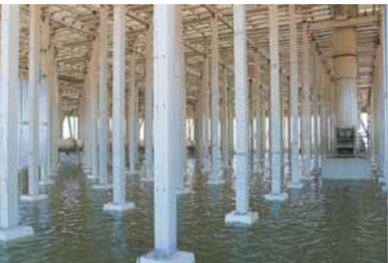
Водосборный бассейн второй градирни энергоблока № 1 Ленинградской АЭС-2. Фотография с официального сайта предприятия ( www.lnpp2.ru ).
