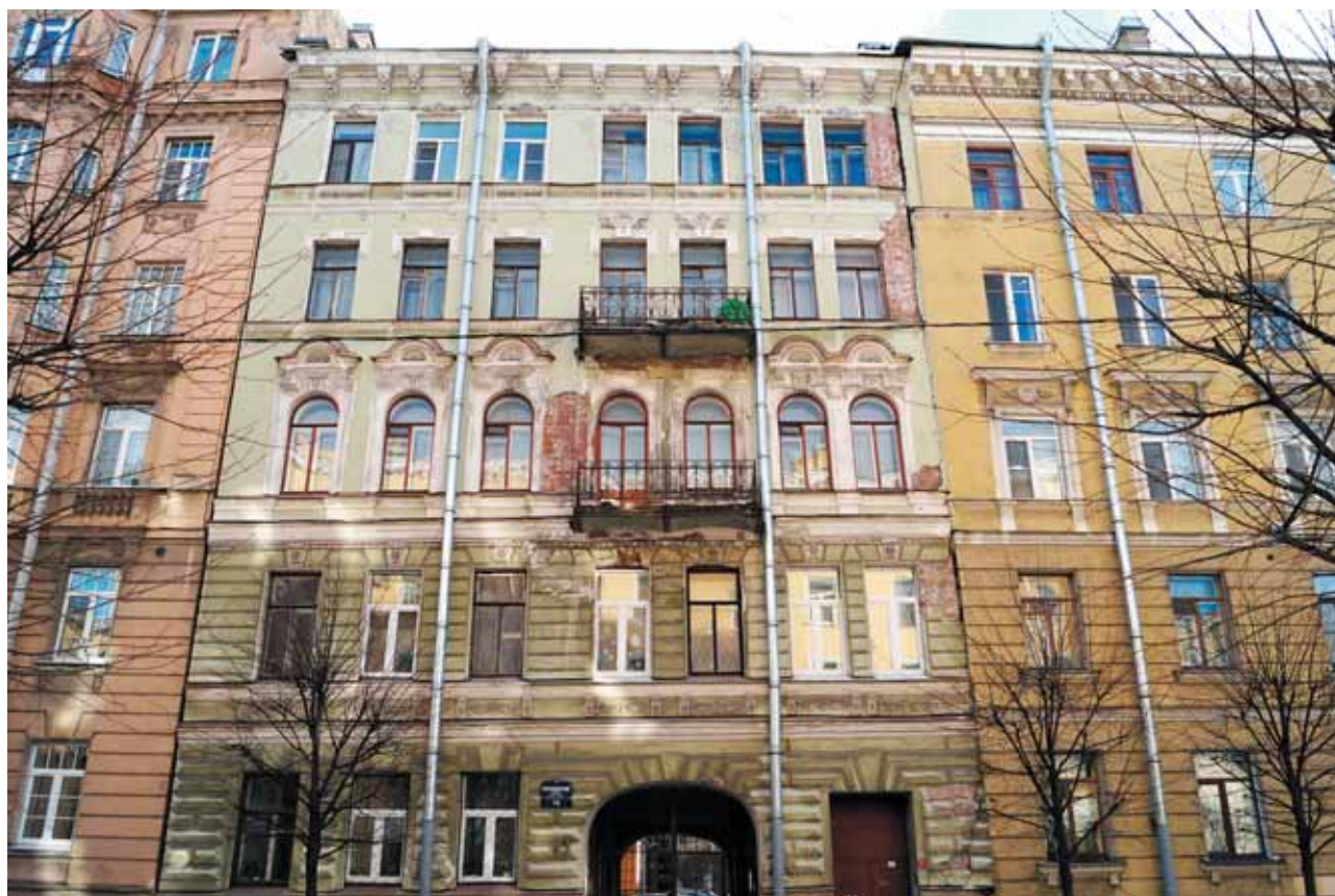
Фасад жилого дома с поврежденной отделкой (Красноборский пер., д. 7/9).
